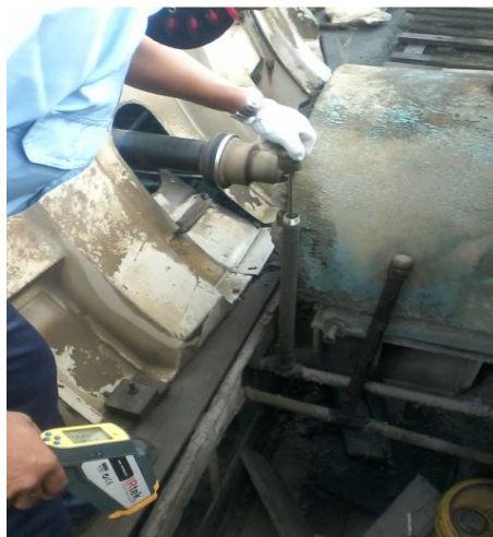
Gambar 3. 5 Pemeriksaan Level Oli Cooling Tower Fan .
